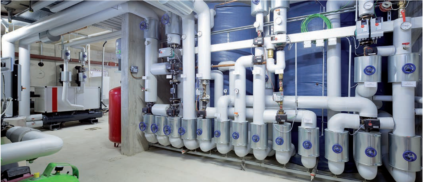
Bild 7. Zentrale Heizung und Warmwasserbereitung
